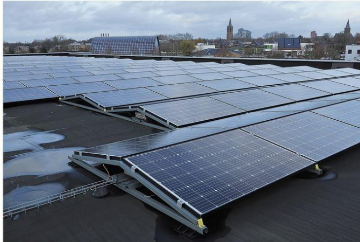
Project de Wetering met de twee kerktorens van het oude dorp op de achtergrond.
